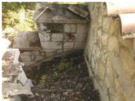
Στέγη πριν την επισκευή
