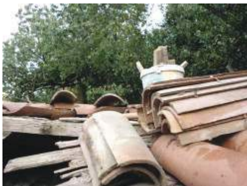
Στέγη πριν την επισκευή
