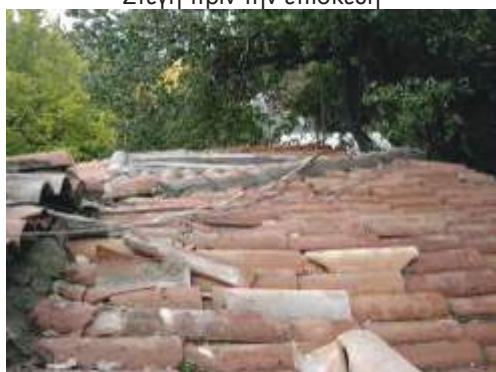
Στέγη πριν την επισκευή
