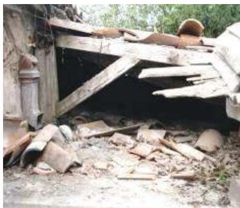
Στέγη πριν την επισκευή
